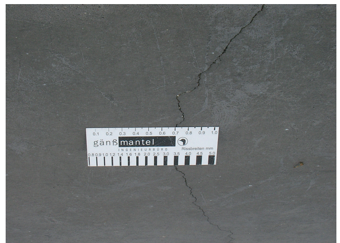
Bild 3: Detail eines Risses an einer Betonstele
