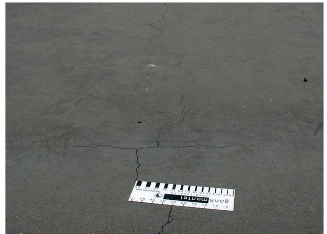
Bild 2: Rissverlauf an einer Betonstele
