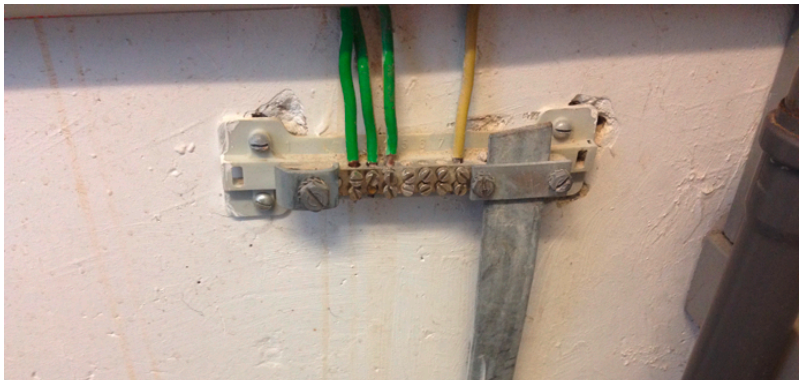
Abb. 1: Beispiel für einen Fundamenterder an der Hauptpotenzialausgleichsschiene mit abgehenden Schutzpotenzialausgleichsleitern (Quelle: BFE)
