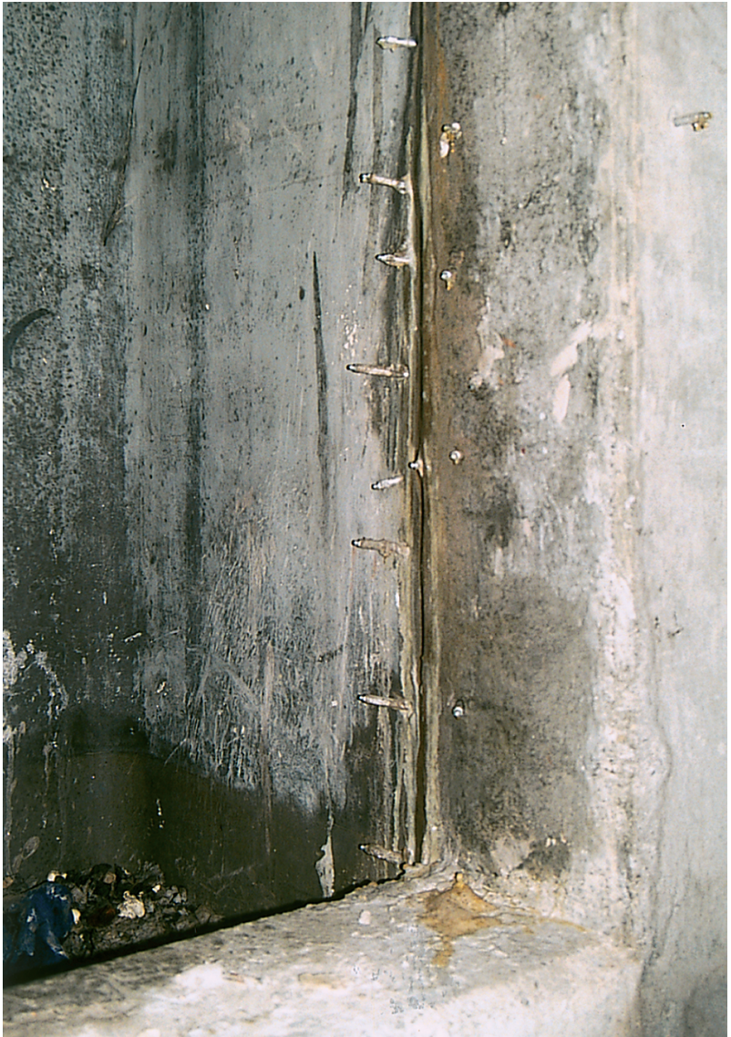
Abb. 2: Bohrpacker in der Übergangsfuge Fertigteil/Wannenkonstruktion; die Fuge ist bei neuerlichem Wasserzutritt wiederum undicht
