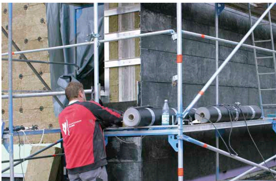
▲ Montage der Schiefer am linken Abschluss der Fassade: Bei spalttrauen Steinen empfiehlt es sich, etwa 5 mm der Steinkante stehen zu lassen, damit die Gehrung scharfkantig durchläuft
