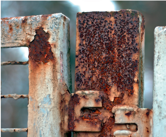
Abb. 2: Korrosion gefährdet auf Dauer den Bestand ganzer Konstruktionen.
