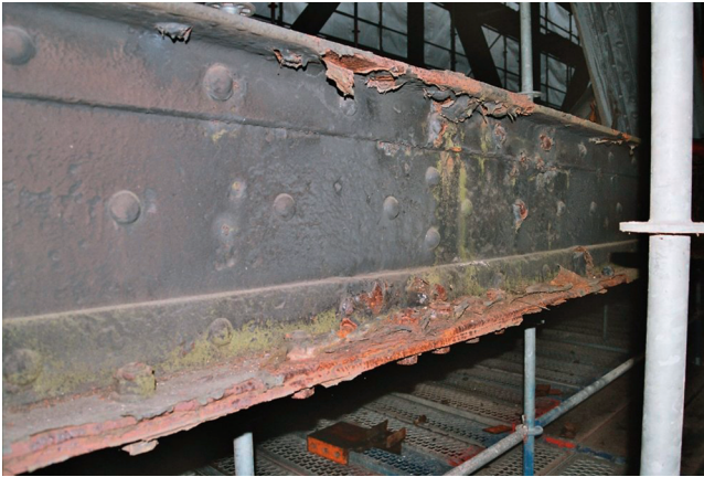
Abb. 4: Korrosion hat diesem Stahlträger deutlich zugesetzt. Rostgrade zeigen an, wie stark eine Fläche durch Korrosion befallen ist.
