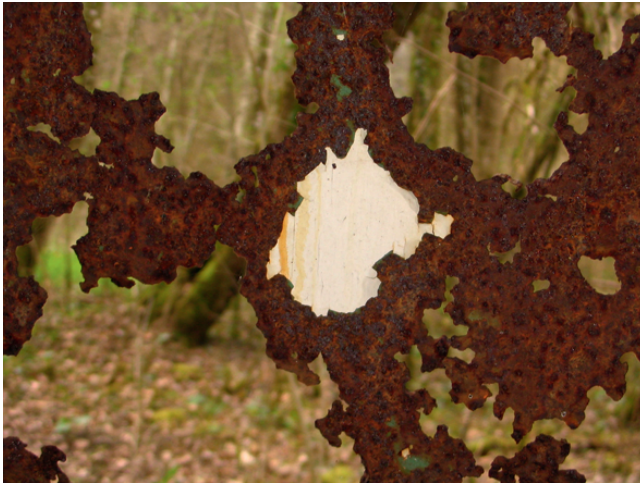
Abb. 5: Widrige Wetterverhältnisse wie Regen setzen dem Metall zu.
