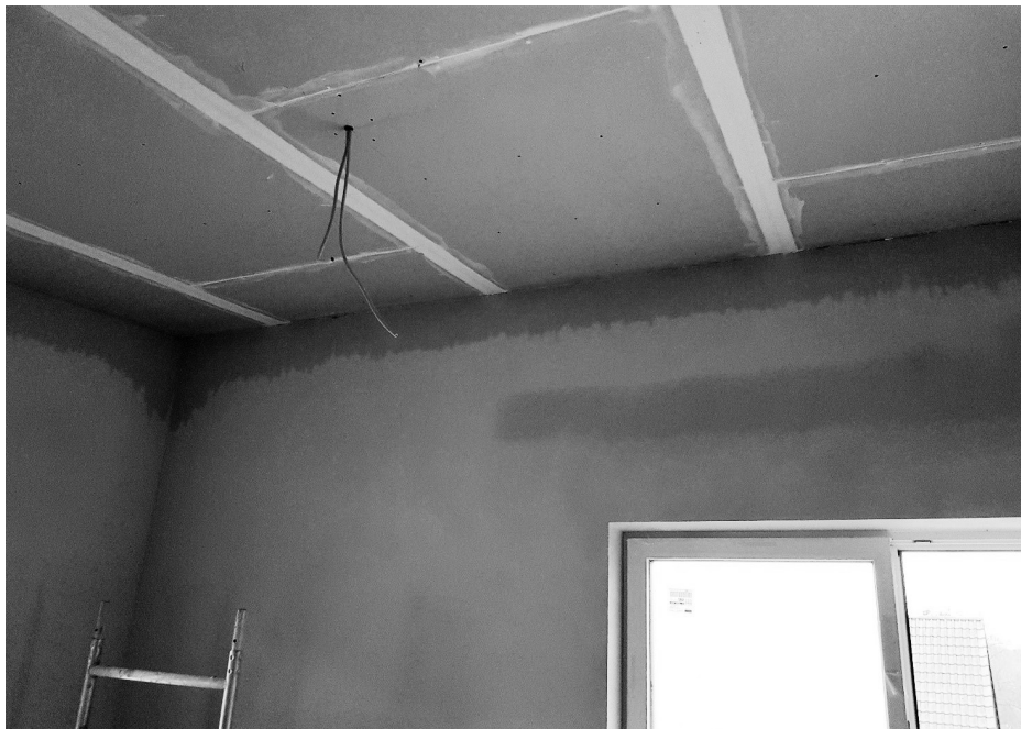
Bild 2: Standard-Ziegelbau (2017) in der Bauphase; durch Tauwasser auf dem Putz zeichnen sich Wärmebrücken ab
