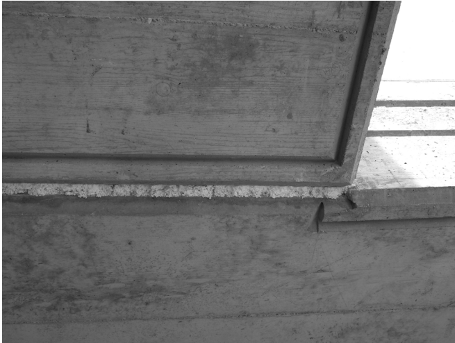
Abb. 3: Verfärbung und Farbabweichung bei einer Sichtbetonfläche
