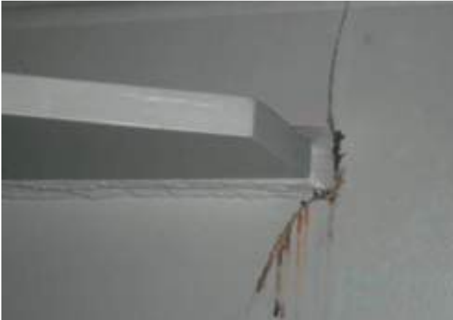
Abb. 16: Typischer Rissverlauf im Auslauf einer Versteifungsrippe
