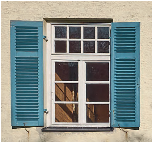
Bild 14: Fenster vor Sanierung (Foto: Stefan Dinkel)
